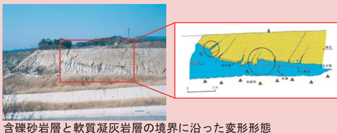
含礫砂岩層と軟質凝灰岩層の境界に沿った変形形態
