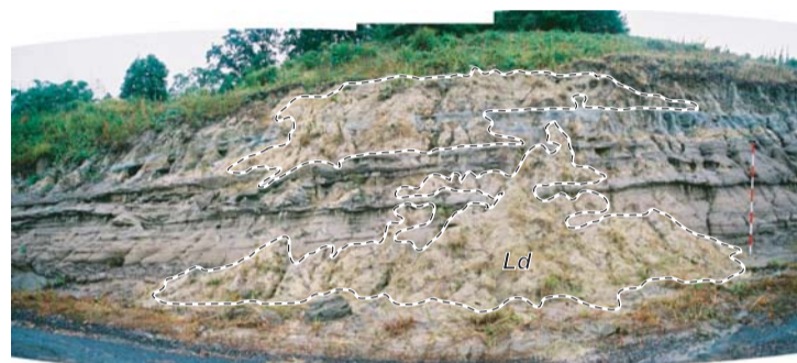
日西原の切土斜面で発生した小規模流動型地すべりの全景写真
