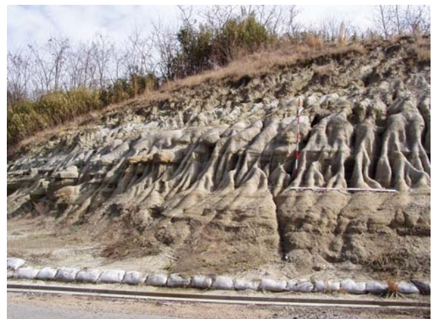
写真-2 切土法面に発達するリル
