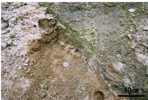
図-5 砂岩ブロックと破碎部の境界に凝灰岩が貫入
