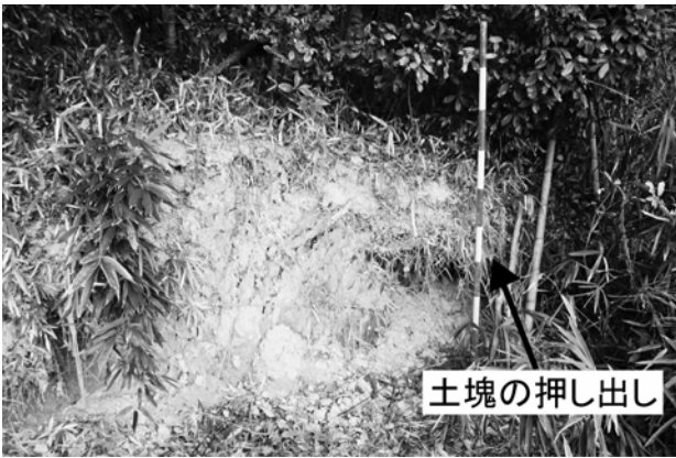
写真-4 地すべり末端部の軟質凝灰岩層の押し出し状況
